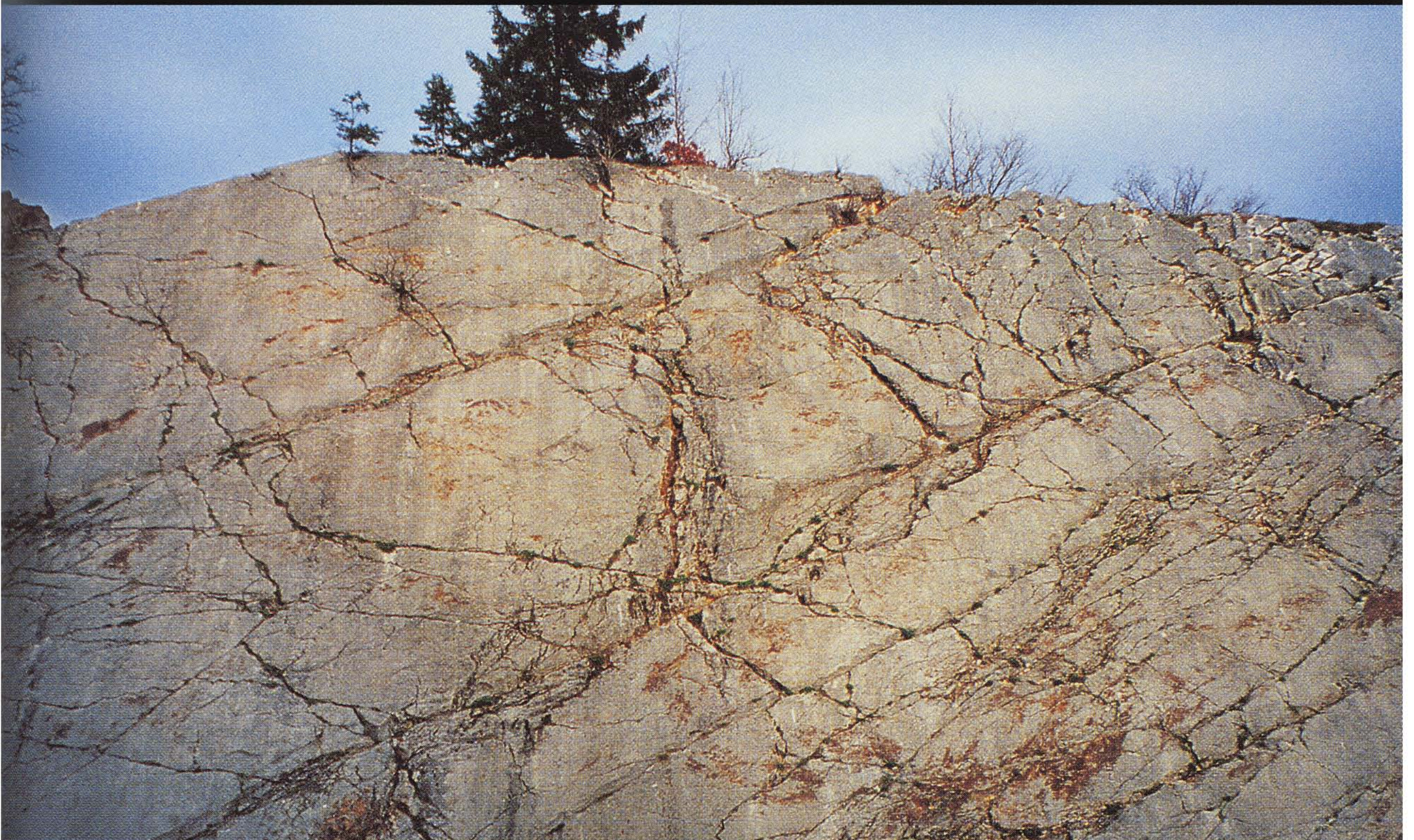
Photo B Dalle de calcaire du Malm; les fissures élargies par l'eau d'infiltration révèlent des inclinaisons préférentielles.
