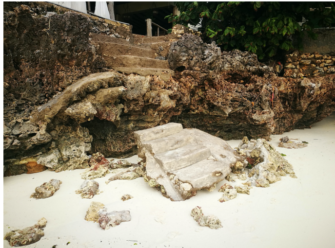
Figure 6. Destruction d'infrastructures touristiques sur le littoral de Nungwi. Janvier 2018
