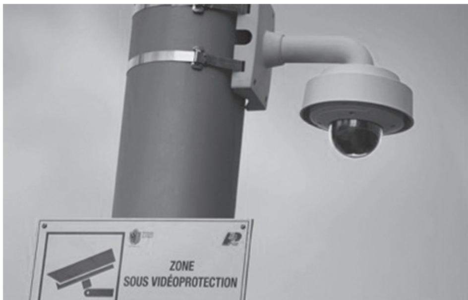
Zone sous vidéoprotection
