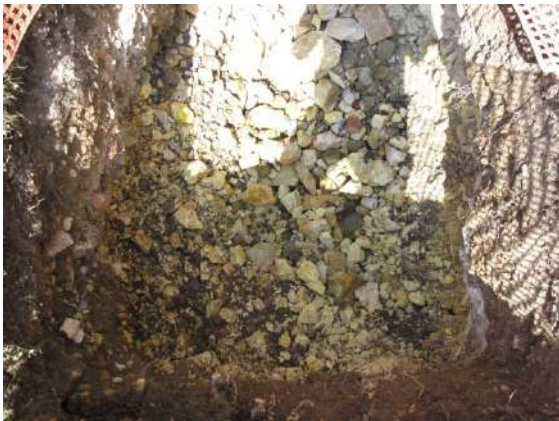
b) Injection de la duasyne dans la fouille IEN3 (coloration persistante des blocs calcaires en fond de fouille)
