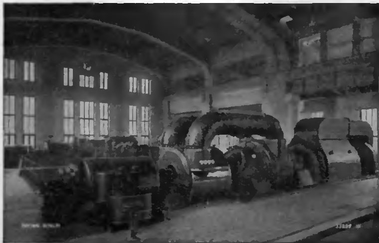
Turbine à vapeur à trois cylindres Brown Boveri, 36 000 kW., 3 000 t/min., 120 at. abs., 480° C, surchauffe intermédiaire. Premier groupe à très haute pression en Europe. En service depuis 1931.
