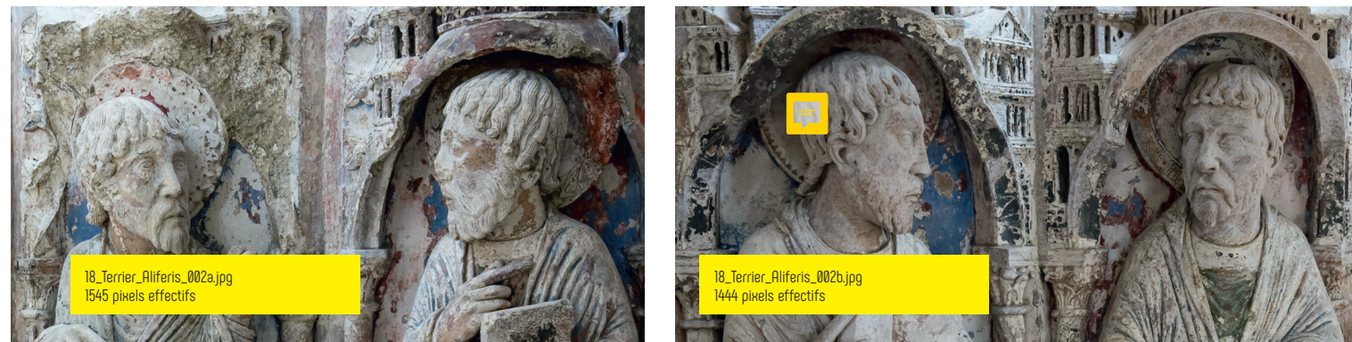
Fig. 2 Angers, cathédrale Saint-Maurice, façade occidentale : dais des retombées droite et gauche des voussures intérieures. T. Fox/Drac Pays de la Loire
